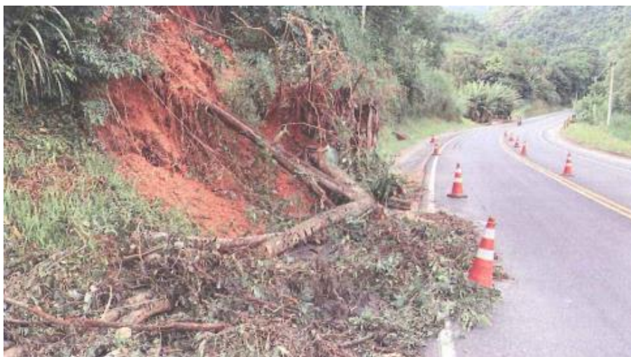
Foto 8 – Queda de barreira - Km 093+000 N
